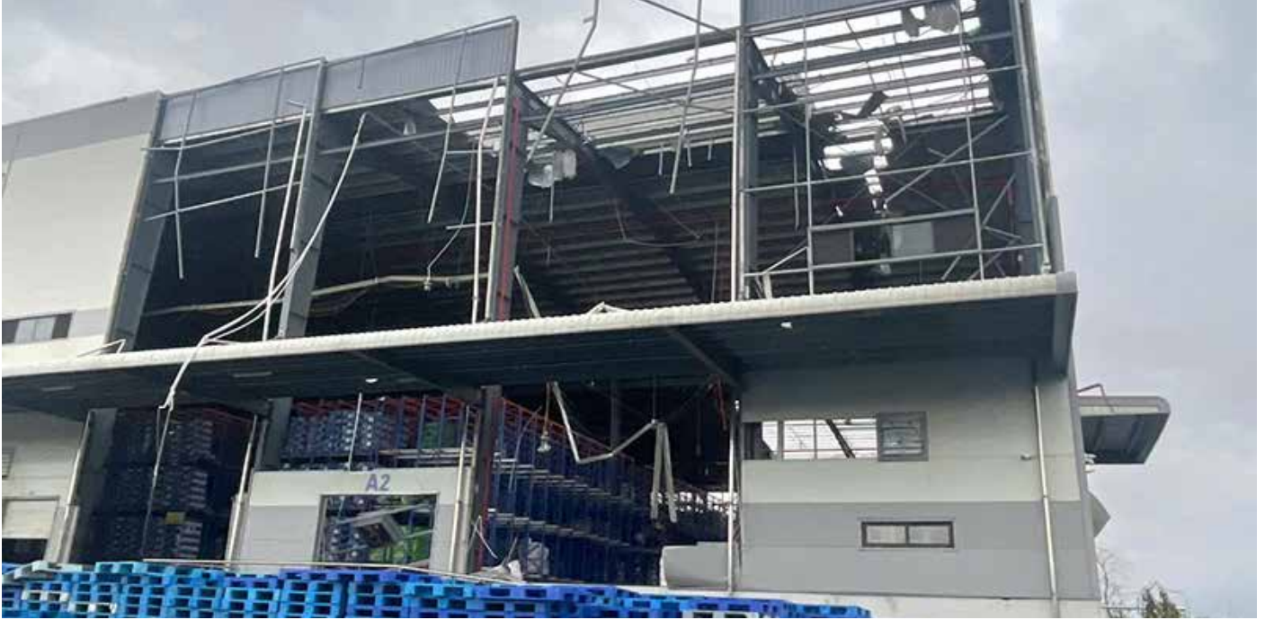
Hiện trường một nhà máy bị cơn bão số 3 tàn phá
